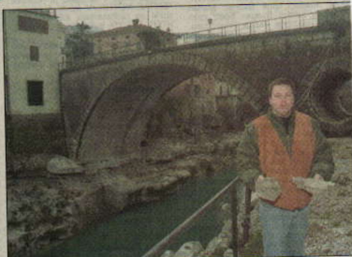
Bližnji сосед Ermin Hvalica s kamenjem, ki se dan za dnem kruši iz oboka znamenitega kanalskega mostu (Slika: L. Caharija/FPA)
